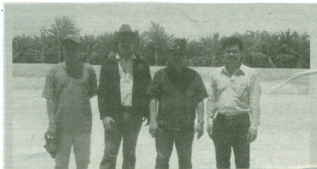
ตรวจรับงาน ● นายก่อเกียรติ จันทร์พิงสุข ผู้อำนวยการสำนักงานพัฒนาที่ดินเขต 2 กรมพัฒนาที่ดิน พร้อมคณะกรรมการตรวจรับงานเดินทางไปตรวจและติดตามงานก่อสร้าง สระเก็บน้ำ บ.วังใหญ่ ม.2 ต.หนองใหญ่ อ.หนองใหญ่ จ.ชลบุรี
